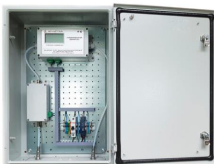
ж) газоанализатор стационарный "Бинар-2П" с системой пробоподготовки в монтажном шкафу
